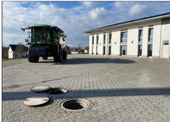
Bild 4-2: An den Hydroshark angeschlossenes Hofgelände der Firma Hofelich Landtechnik GmbH in Gussenstadt
