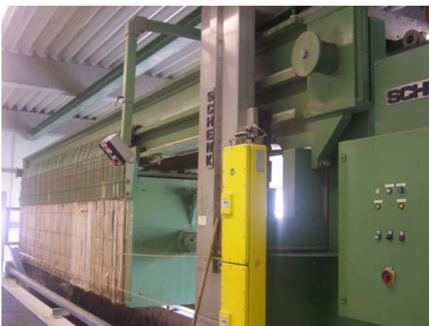
Kammerfilterpresse zur Schlammentwässerung
